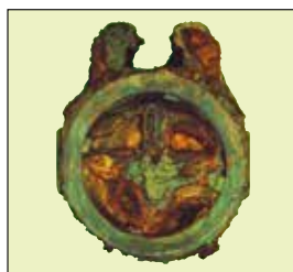
腐食した鑄鉄バルブのジス
