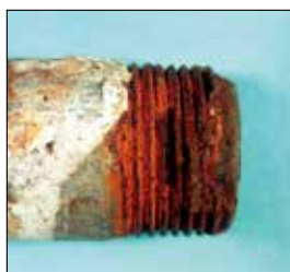
ねじが欠落したライニング鋼管
