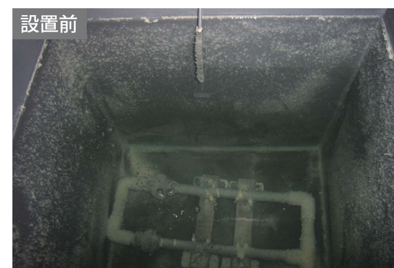
※配管洗浄から1週間後
