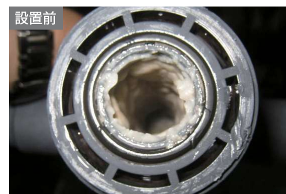
※配管洗浄から1週間後
