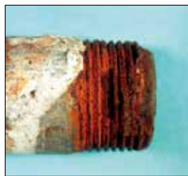
ねじが欠落したライニング鋼管
