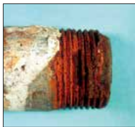
ねじが欠落したライニング鋼管
