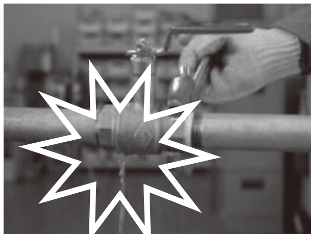
接合部分よりの水漏れ
