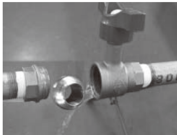
ボールの脱落
