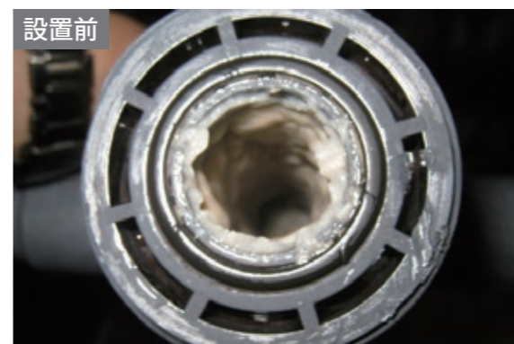
※配管洗浄から1週間後
