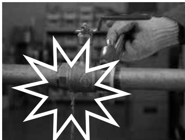
接合部分よりの水漏れ
