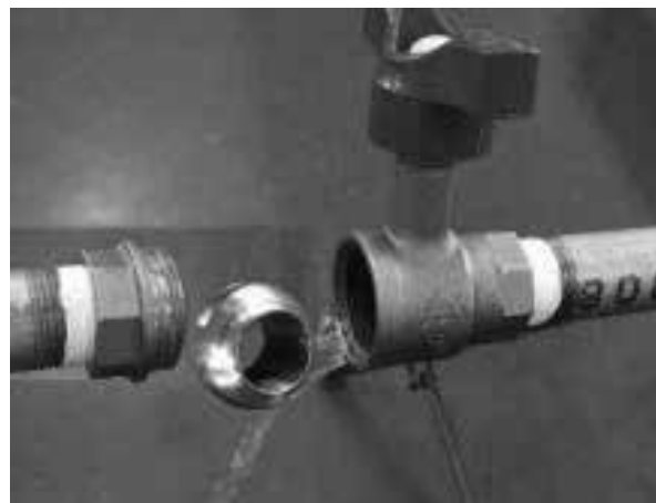
ボールの脱落
